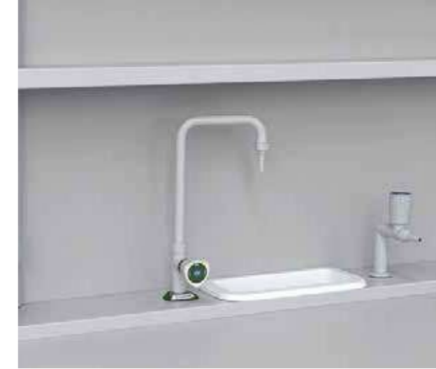
Su ve Gaz Tesisatı
